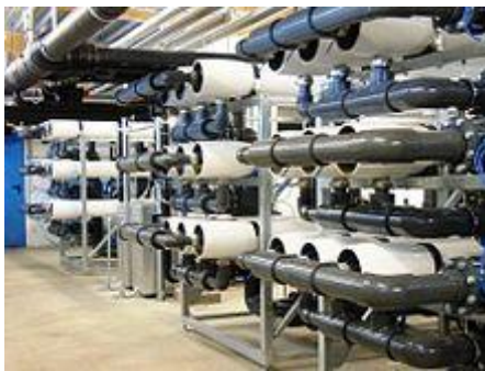
Ultrafiltration im Freibad
