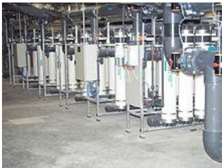
Ultrafiltration Bad Aibling
